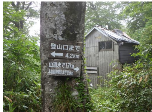
屋根が破れた避難小屋
